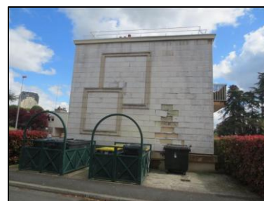
Photo N° 46 ECH-N°6 -1R+1-Bat.4 Calmette Pignon Murs Colle + dalles
