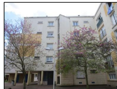
Photo N° 64 ECH-N°36 -1R+4 - Esc.7 J.SIEG. Façades Murs Mortier + peinture
