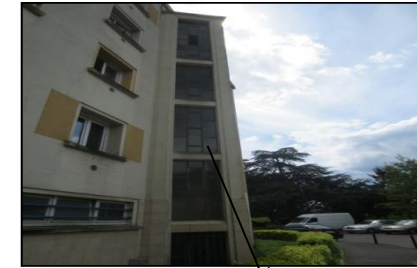
ECH-N°35 -1R+4-Esc5-6J.SIEG.Baie vitrée esc/Baies vitrées Mastic, (photo n° 91)
