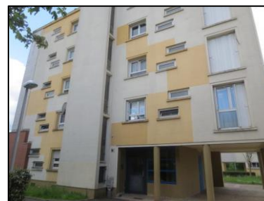
Photo N° 72 ECH-N°41 -1R+4-Esc. 10 J.SIEG. Façades Murs Mortier + peinture
