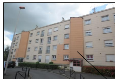
ECH-N°27 -1R+3-Esc11-12 Ribot Baievitrée esc/Baies vitrées Mastic, (photo n° 40)
