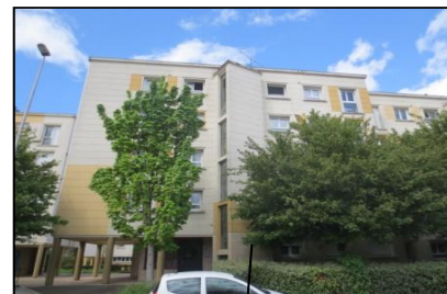
ECH-N°28 -1R+4-Esc.1J.SIEG.-Façades/Murs Mortier + peinture, (photo n° 87)
