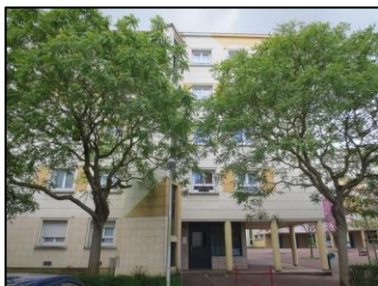
Photo N° 56 ECH-N°31 -1R+4 - Esc.4 J. SIEG. Façades Murs Mortier + peinture
