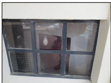
Photo N° 21 ECH-N°10 -1R+4 - Esc1-2Ribot Baies vitrées escalier Baies vitrées Mastic
