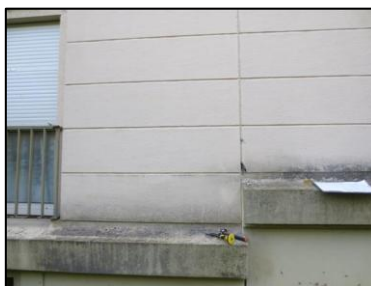
Photo N° 83 ECH-N°20 -1R+3 - Esc.4à7 Ribot Façades Joints - Murs Joint de dilatation mortier + mastic
