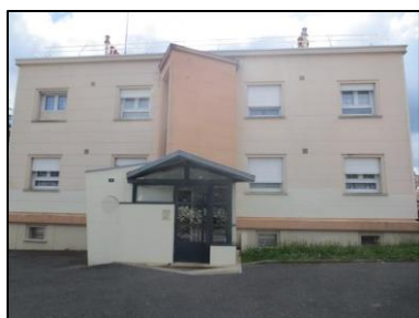
Photo N° 43 ECH-N°9 -1R+1 - Bat.4 Calmette Baie vitrée escalier Baies vitrées Mastic
