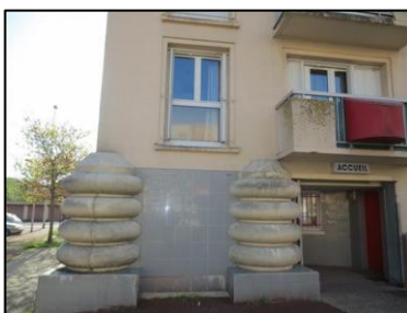
Photo N° 5 ECH-N°4 -1R+8 - BAT.13 Façade Moultures Enduit + peinture
