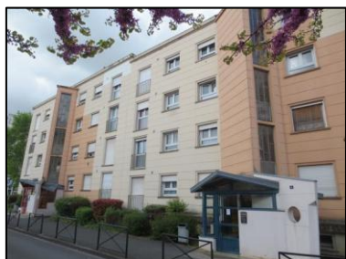
Photo N° 31 ECH-N°24 -1R+3 - Esc8-9 Ribot Baies vitrées escalier Baies vitrées Mastic
