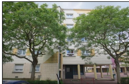
ECH-N°31 -1R+4-Esc.4 J. SIEG.- Façades/Murs Mortier + peinture, (photo n° 56)
