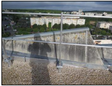
Photo N° 103 ECH-N°43 AMIANTE CIMENT -1R+8 - BAT.13 Toiture Acrotère Plaques planes (Fibres-ciment)
