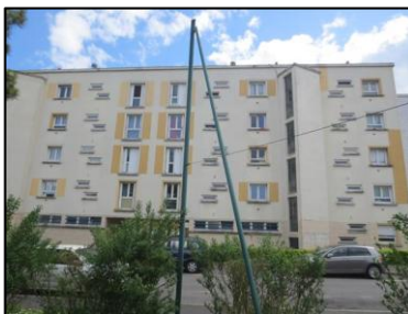
Photo N° 62 ECH-N°34 -1R+4 - Esc.5-6J.SIEG. Façades Murs Mortier + peinture
