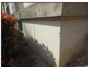
Photo N° 86 ECH-N°25 -1R+3 - Esc.11-12 Ribot Façades Murs bas – soubassements Mortier + peinture
