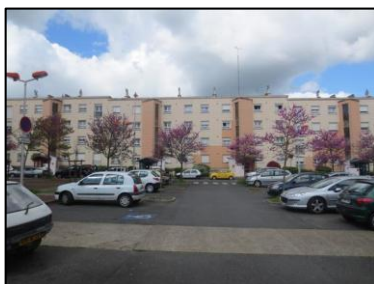
Photo N° 27 ECH-N°19 -1R+3 – Esc. 4à7 Ribot Baies vitrées escalier Baies vitrées Mastic
